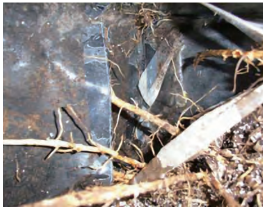
写真9 シート防水層の接合部への根系の侵入
