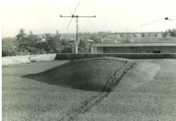
写真2 筆者が見た中で最大級の屋上防水層のふくれ
