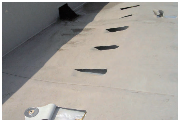
写真2 台風による防水層の破損
