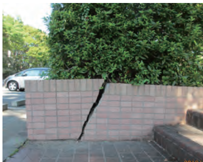
写真2 植物の根で割られてしまった擁壁
