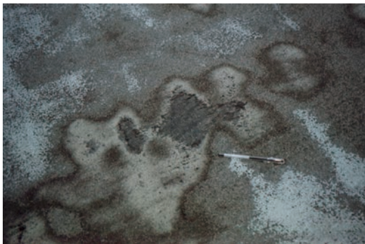
写真3 防滑層が磨滅し、防水層が露出
