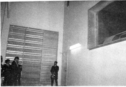
写真-12 排気ダンパー(左), 排気風道(右)
