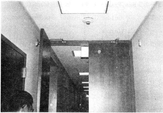
写真-14 煙感知器連動防火ドア(常開)
