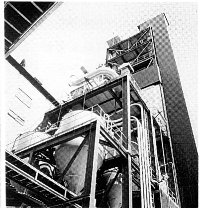
写真2 流動床セメント焼成プラント
