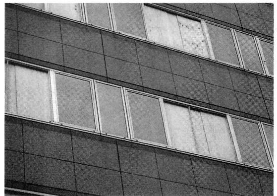
写真4 横連窓のFix部分の破損例 (三宮地区)
