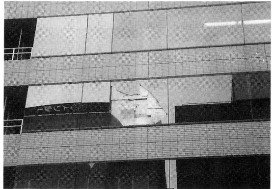
写真11 内部の物体衝突による破損例 (三宮地区)
