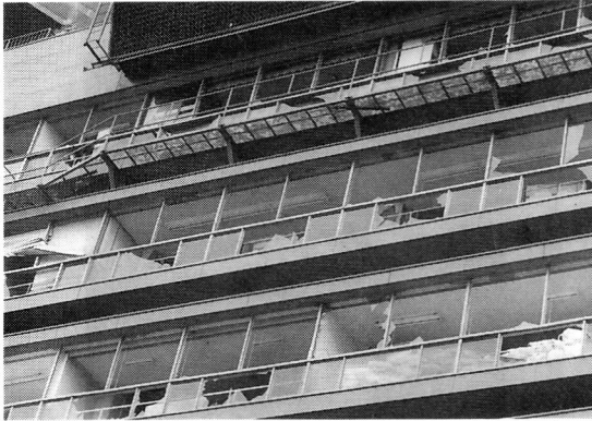
写真1 バテ施工の窓ガラスの被害例 (三宮駅前)
