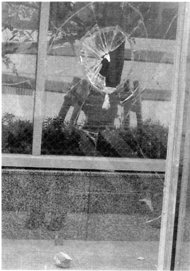
写真10 外部からの飛来物による破損例 (三宮地区)
