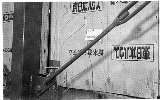
写真3 合板のはがれ
