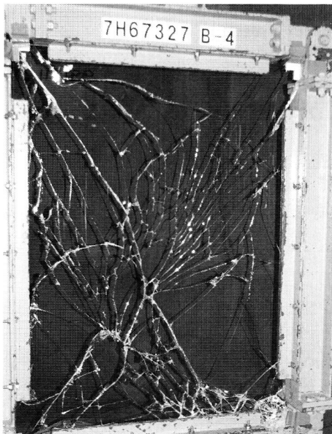
写真2 層間変位による破壊状況
