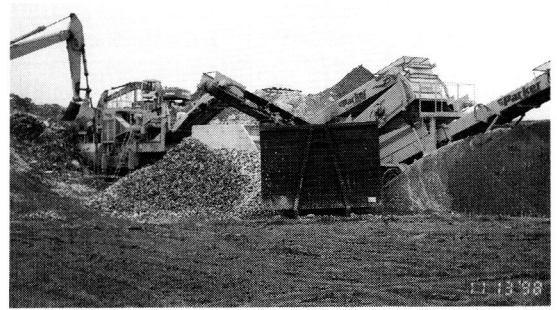
再生骨材の製造プラント
