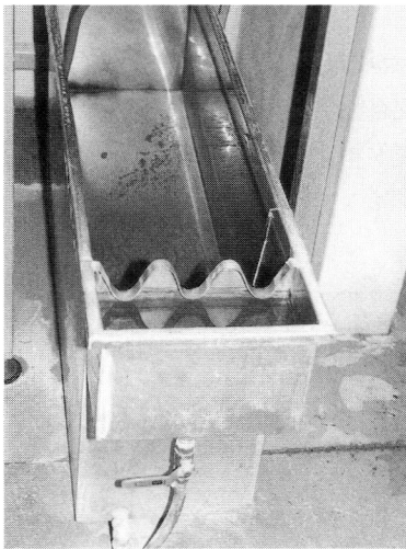
写真2 越流装置のある水槽
