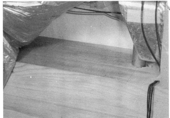
写真6 結露状況（土台：試験体No.2）
