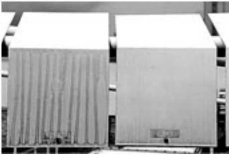
写真3 塗装材の雨筋汚れ
