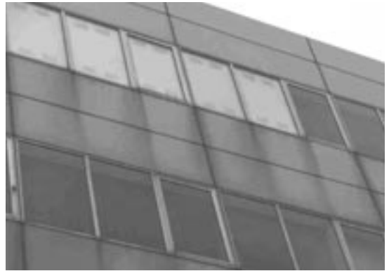
写真6 シリコン系シーリング材複合塵埃付着 (開口下部)
