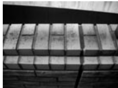
外壁汚染の例2
