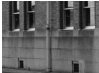
外壁汚染の例4
