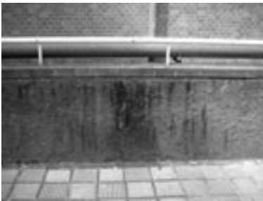
外壁汚染の例1
