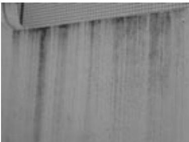
外壁汚染の例3
