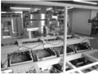
路盤材料自動選別装置
