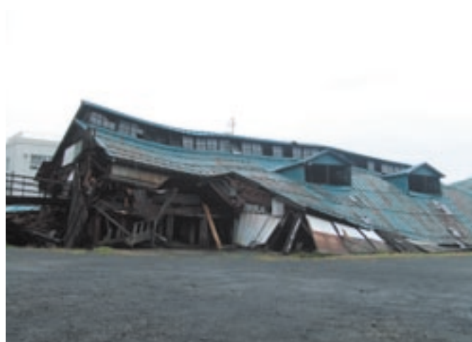
写真2 木造倉庫の地震被害
