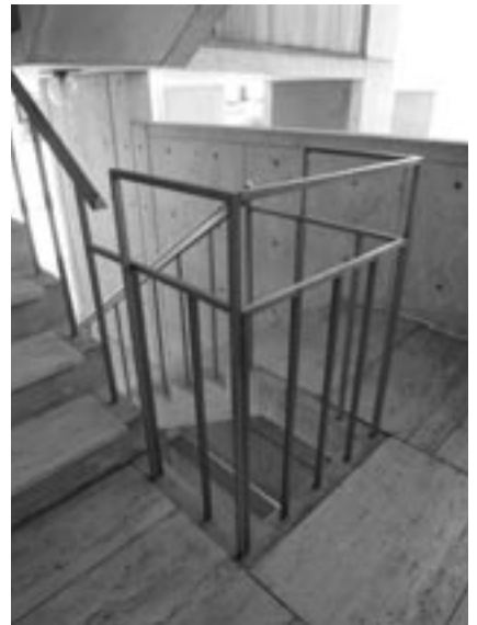
写真8 ソーク研究所(ルイス・カーン/ラ・ホヤ)の後付け嵩上げ手摺
