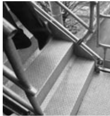
写真5 さいたまアリーナ建設工事現場の1段ずれた仮設階段
