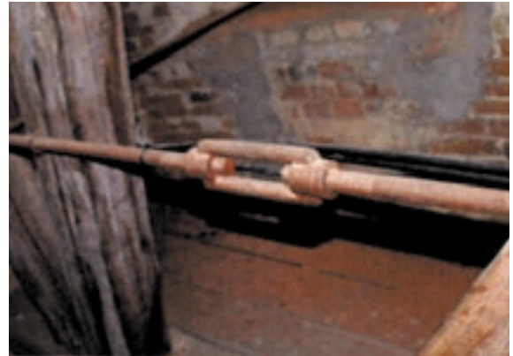
写真7 壁面補強引き金物に連結しているターンバックル
