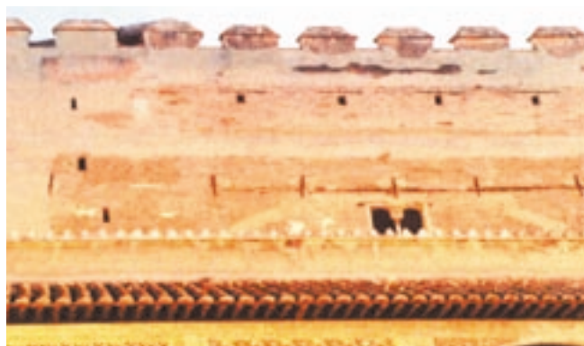
写真1 城壁補強の引き金物の一例
