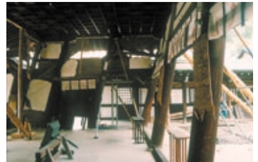
写真15 倒れかかっている神社内部
