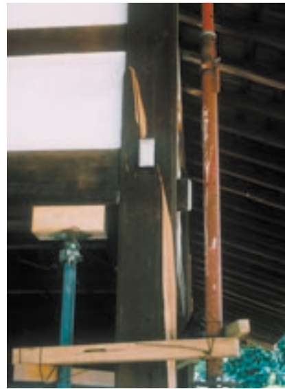
写真14 長田神社絵殿の 柱の折れ
