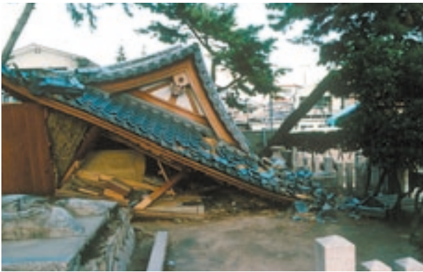
写真12 倒壊した神社
