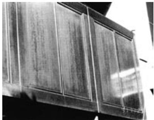
写真1 仕上材自体の変化に伴う汚れ（腐食）
