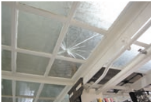
写真6 ガラス床の亀裂 / やはりガラスが割れないかという不安感がないといえは嘘だが、乗ってみると案外平気なものである (Pratt Institute 図書館, ニューヨーク)
