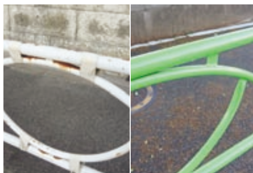
写真16 ガードフェンスの挟まれ対策 / 挟まれ事故の対策と推定されるゴムテープが徹底して巻かれているが、最近になって更新された箇所では、金具付きのディテールが採用されている（目黒区）。
