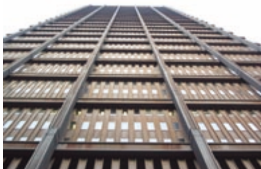
写真13 水を満たした耐火構造・1 / U S スチール本社ビル（ピッツバーグ）には、コルテン鋼の柱・梁に液体を満たす耐火方法が採用されている。
