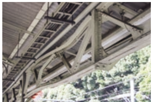
写真8 戦災で曲がったままの鉄骨 / JR中央線・千駄ヶ谷駅のホーム上屋には、戦争時の火災で曲がった鉄骨がある。改修される前に見ておきたい。
