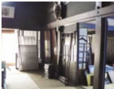
写真7 能登半島沖地震の被災家屋5
