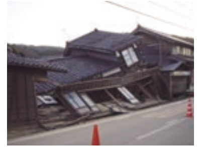
写真4 能登半島沖地震の被災家屋2
