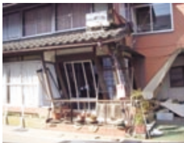
写真3 能登半島沖地震の被災家屋1
