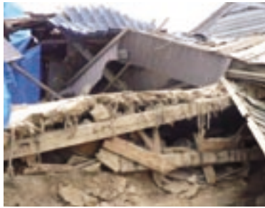
写真6 能登半島沖地震の被災家屋4
