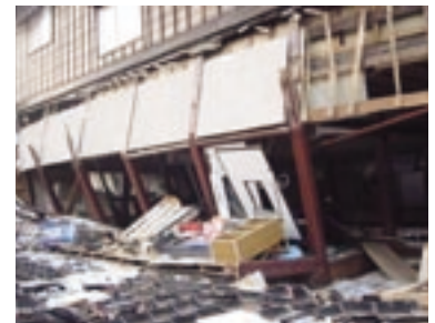
写真5 能登半島沖地震の被災家屋3
