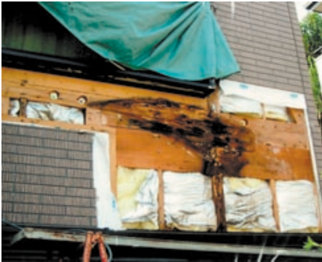
写真1 雨水の浸入により構造体を腐食させている例（サイディング仕上げ）
