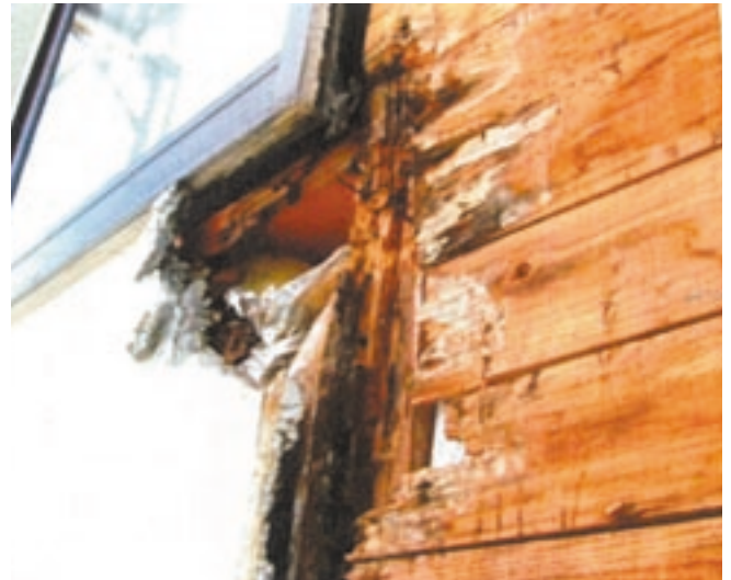
写真2 雨水の浸入により構造体を腐食させている例（モルタル仕上げ）
