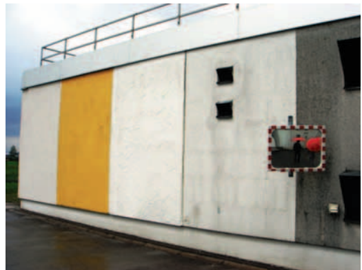
写真2 IBPの屋外曝露試験場にて（写真右端の黒ずんでいる部分がカビの繁殖している塗装材）
