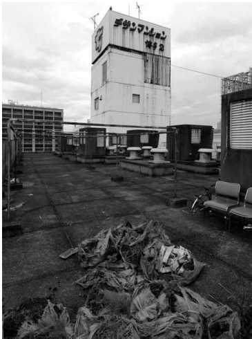
屋上の給水タンクを覆うサイン、屋上防水、塔屋などは適切に修繕されず、ゴミが散乱し、荒廃している
