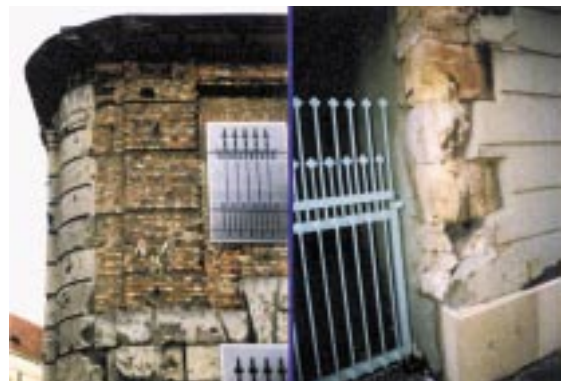
写真7 厚塗りモルタルの剥落事例
