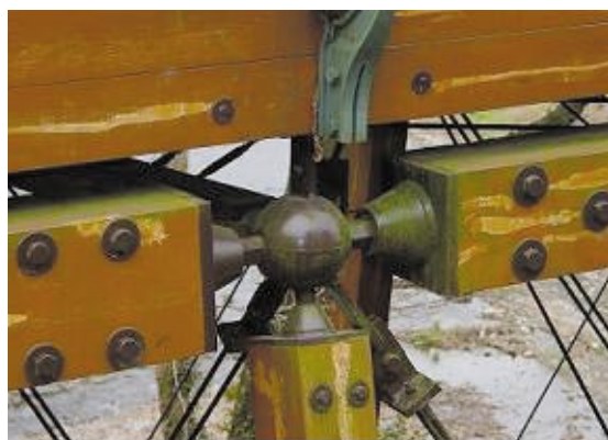
写真3 ボールジョイントによるトラス接合部
