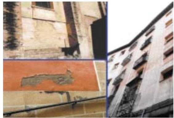
写真2 れんが造の外装リニューアルを薄塗り仕上げした状況およびその不具合状況
