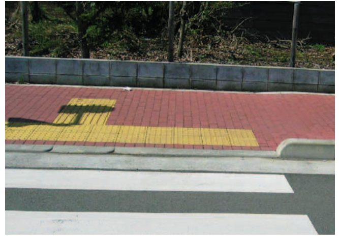
写真5 使用例2 (境界ブロック及び視覚障害者誘導用ブロック)
