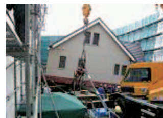
写真7 倒壊時の状況
