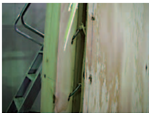
写真11 くぎ頭の面材貫通
