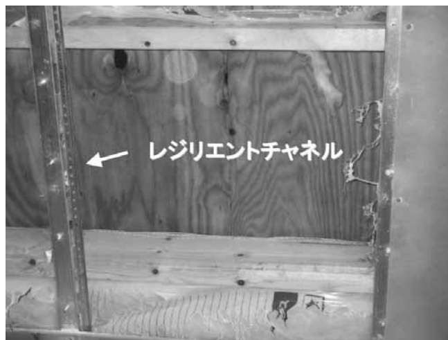
写真5 試験後の内部（試験体記号B）
