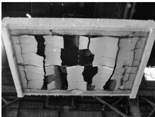
写真3 試験後の加熱側の状況（試験体記号A）
