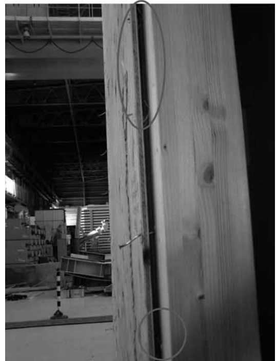
写真1 くぎ頭の貫通状況
