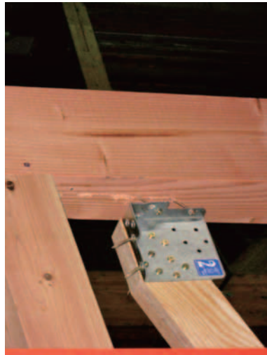
写真2 ビスの破断および引き抜け (ビスが破断したものと、引き抜けたものが混在)
