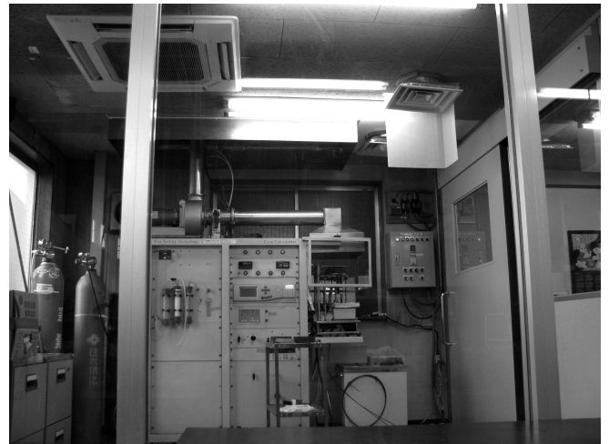
改良後の発熱性試験室
