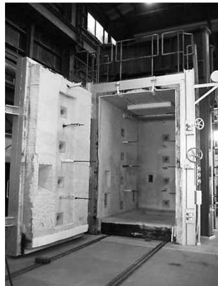
写真1 四面載荷加熱炉の全景
