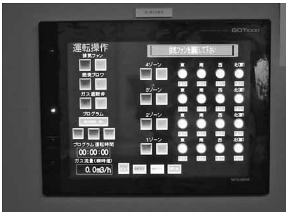
写真4 制御盤パネル
