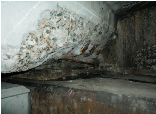
写真2 凍結防止剤により塩害が生じた桁端部
