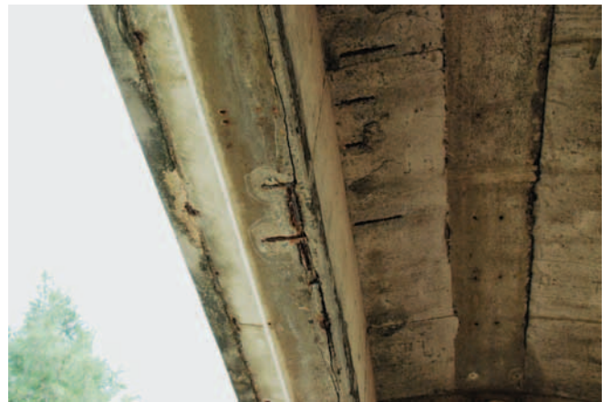
写真1 塩害によるコンクリート橋のひび割れ・鋼材腐食
