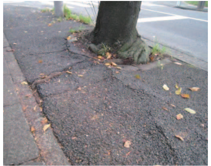
写真3 根の肥大によるアスファルト歩道舗装の持ち上げとひび割れ
