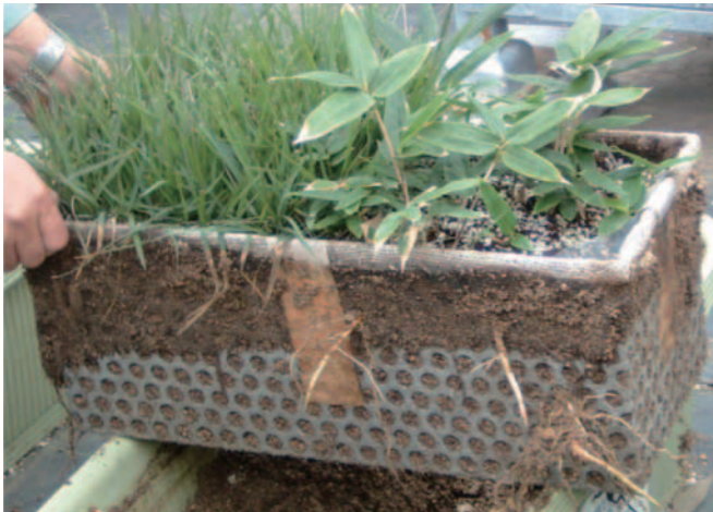
写真1 クマザサ地下茎の防水層の貫通
