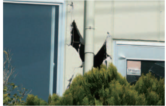
写真11 開口部横のパネルの破壊(両側に開口部に挟まれたパネルであることから、開口部の拘束によるせん断破壊と考えられる。)
