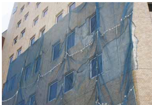
写真2 地震動により比較的大面積にわたって剥離したタイル張り仕上げ層
