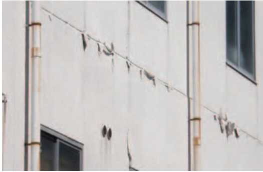
写真10 パネル横目地部分の連続した破損(挿入筋構法の取付け部の被害であるが、上下階の開口部が影響した可能性も考えられる。)
