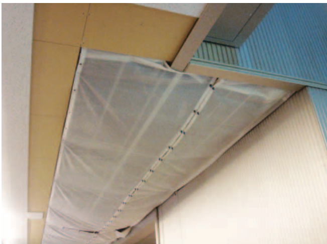
写真5 オフィスビル天井の落下
