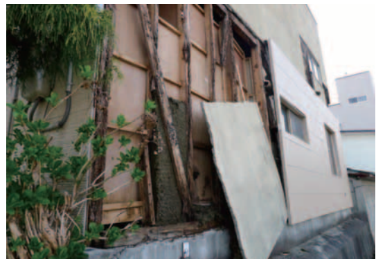
写真6 木造住宅のモルタル塗り仕上げの落下
