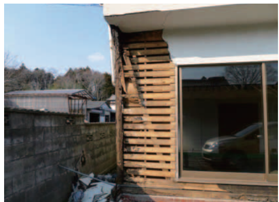
写真4 木造店舗併用住宅のモルタル塗り仕上げの落下
