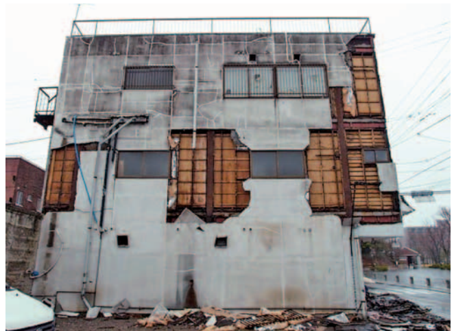
写真1 ラスシート外壁の被害
