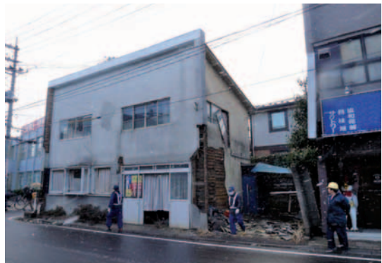
写真5 木造事務所のモルタル塗り仕上げの落下
