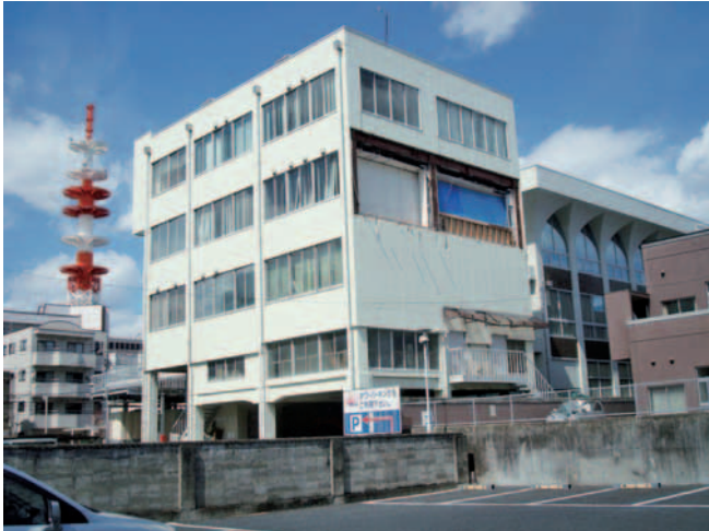
写真2 ALCパネルの被害
