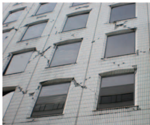
写真1 躯体のせん断ひび割れに伴うタイル張り仕上げ層でのひび割れの発生
