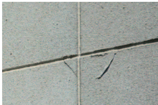
写真8 隣り合うALCパネル角部の亀裂(挿入筋構法で比較的多くみられる被害であり、地震によりパネル角部が競り合い、亀裂が発生した。)
