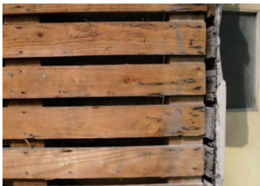
写真7 モルタル塗り仕上げ落下後のラス下地板の状態
