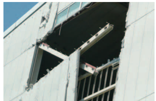
写真12 中間梁の接続部が破断し、パネルが脱落(中間梁の接続部が破断していることより、激しい挙動であったことが推察される。)
