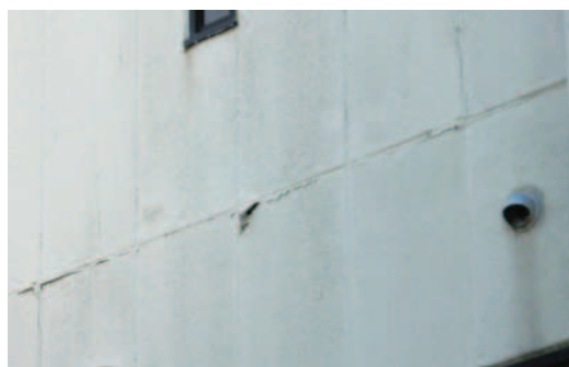
写真9 パネル横目地に沿って連続した亀裂と角部の浮き(地震時に目地シーリング材によりALCパネルが引っ張られ、パネル表層部に亀裂が発生したものと考えられる。)
