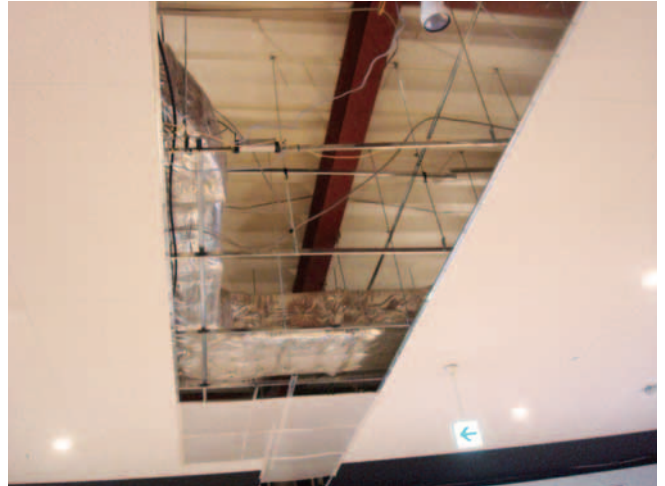
写真6 店舗建築の天井の落下
