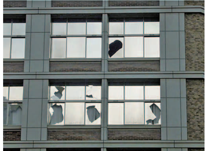
写真3 はめごろしの窓ガラスの破損
