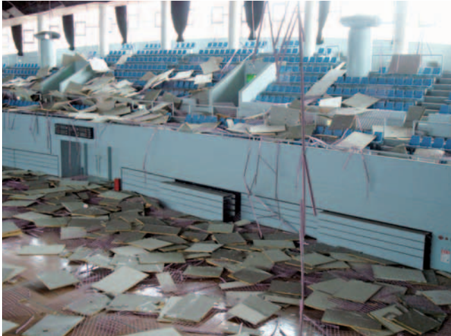
写真4 体育館天井の落下
