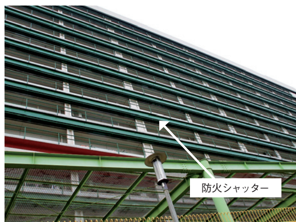
各階に設置された防火シャッター
