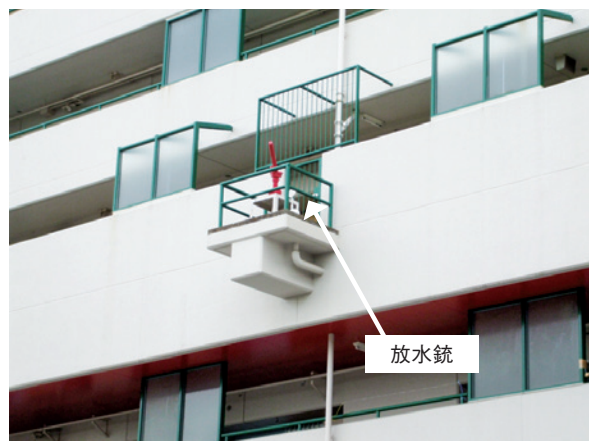
壁面に設置された放水銃
