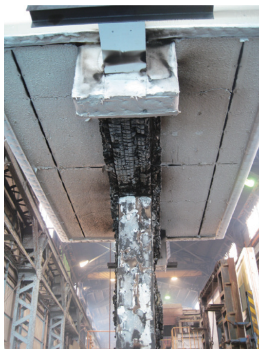
写真4 試験後の試験体の状況(仕様①)
