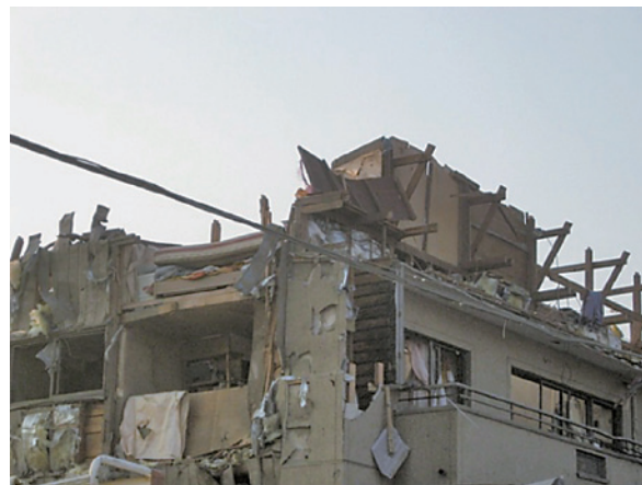
写真1 竜巻被害状況 窓ガラスは割れ屋根材も飛ばされている
