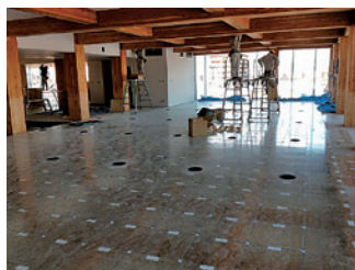
写真9 床噴出し空調
