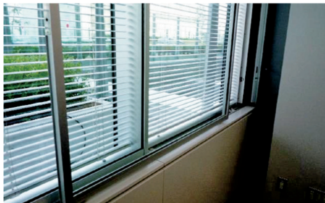
写真1 AFWおよび自然換気スリット インナーガラスを手前に引きスライドさせた状態。閉じれば面一となる。
