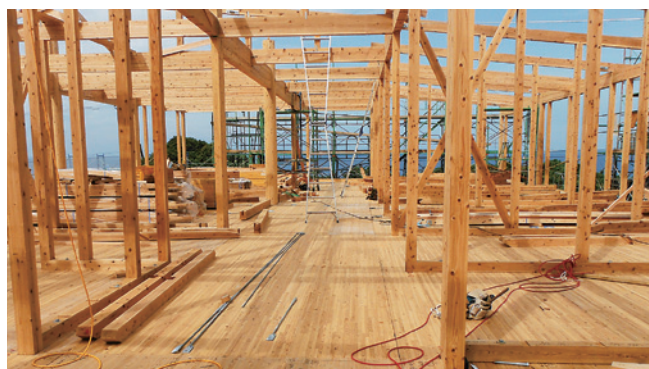
鹿児島県西之表市せいざん病院にて2階床に利用。 CLTはJASがないために構造用集成材で代用した。
