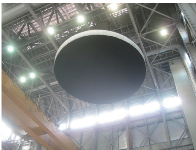
写真12 排煙用フード(直径約10m)
