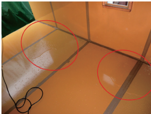
写真1 室内側の漏水状況(写真右側に換気ガラリ設置) 換気ガラリからの吹き出しで室内側に水溜りができている状況
