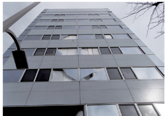
写真16 横連窓の被害 (水戸市)
