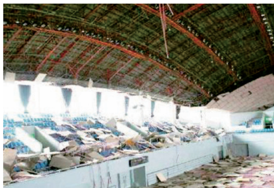
写真3 体育館天井の落下 (宇都宮市)
