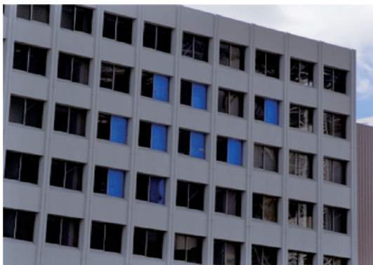
写真14 はめ殺し窓の被害 (水戸市)
