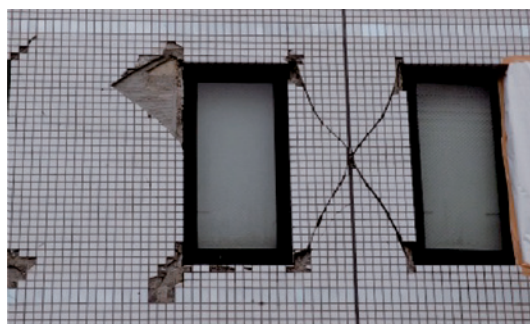
写真7 壁面のせん断ひび割れによるタイル被害 (郡山市)
