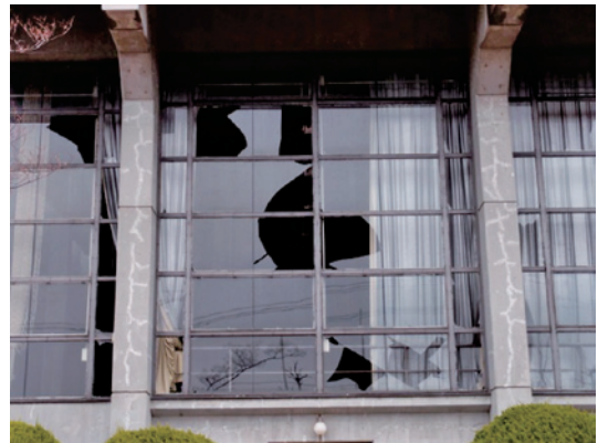
写真15 はめ殺し窓の被害 (郡山市)
