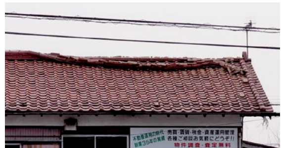
写真1 棟瓦の被害（富士宮市）
