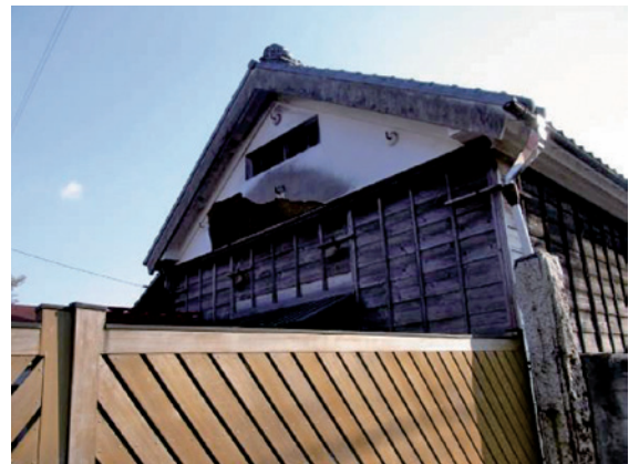
写真2 漆喰壁の被害（成田市）
