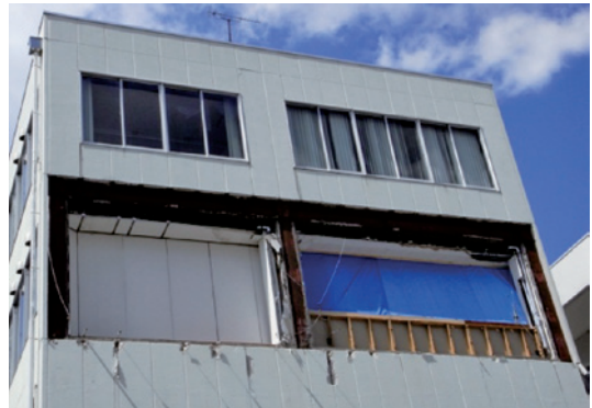
写真9 ALCパネルの被害 (水戸市)
