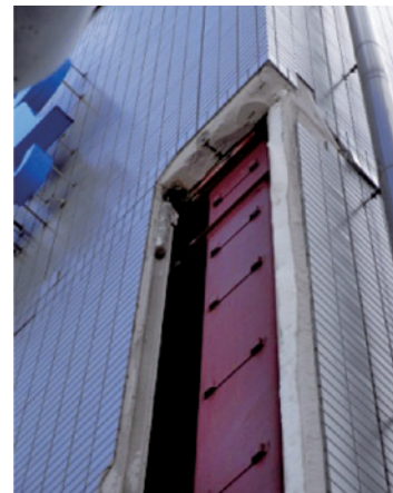
写真11 ALCパネルの被害 (水戸)
