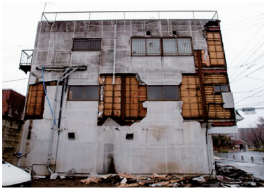
写真8 ラスシート外壁の被害 (郡山市)
