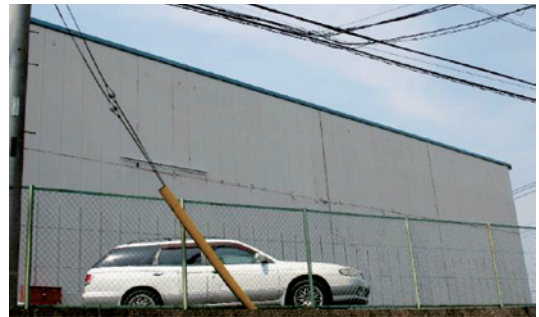
写真10 工場の ALC パネルの接合部の損傷 (栃木県芳賀町)
