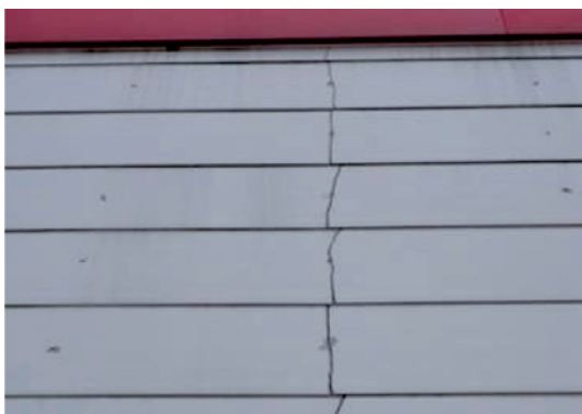
写真19 サイディング外壁のひび割れ (仙台市)
