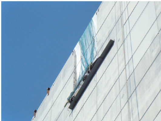
写真18 PC外壁の被害 (仙台市)
