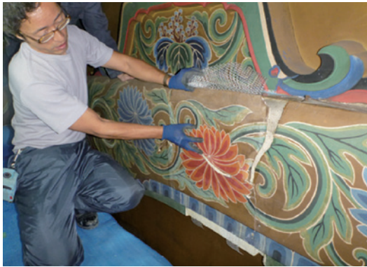
内陣余間の虹梁の剥離状態
