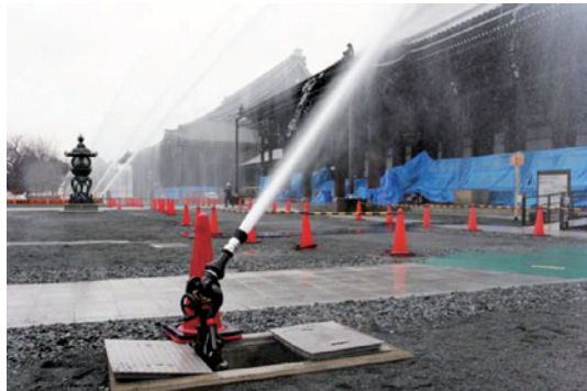
放水銃 地下格納から起倒して放水
