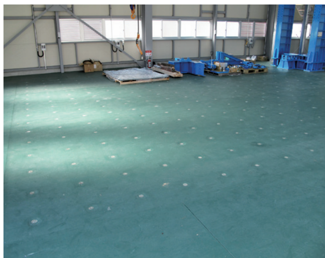
写真8 構造反力床の全景
