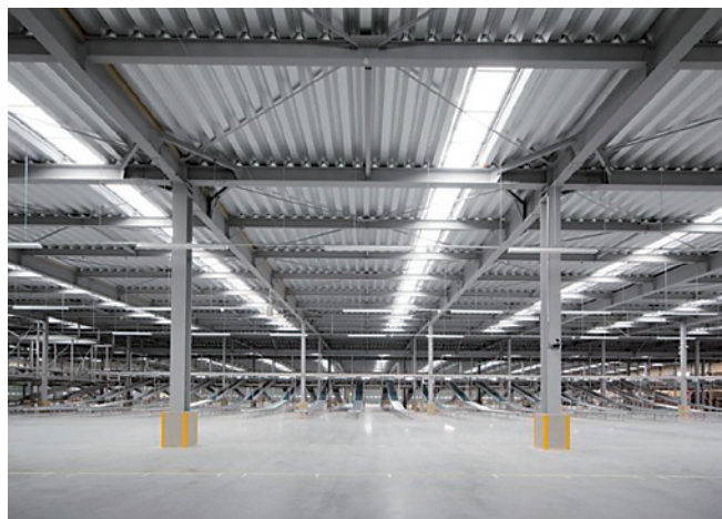
図11 照明設備全体の写真(天井のストライプ上の明かりが設置した光拡散型天窓)
