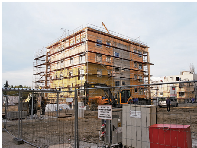
写真3 木造の集合住宅 CLTの構造体, 下から断熱材を施工中。階段室は鉄筋コンクリート
