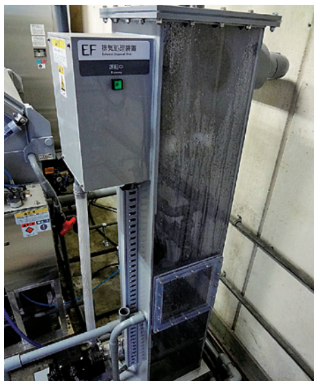
写真4 塩水粒子排気処理装置
