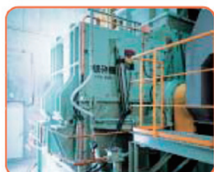
混合廃棄物処理ライン用破碎機 (コンクリートから処理破碎機)
