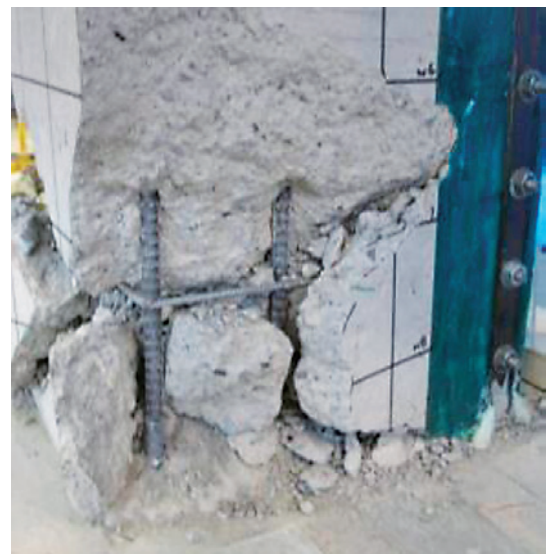
写真2 柱脚部の破壊状況 試験体RA(リブ有り)
