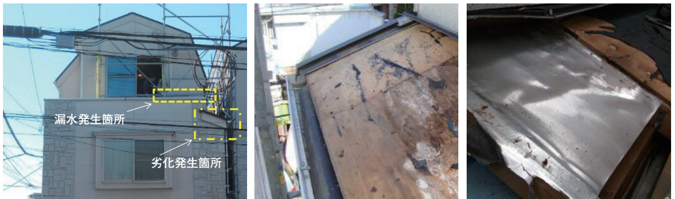
写真2 調査物件外観と劣化部位 (左:西側外観, 中央:劣化部位, 右:アルミクラフト紙)
