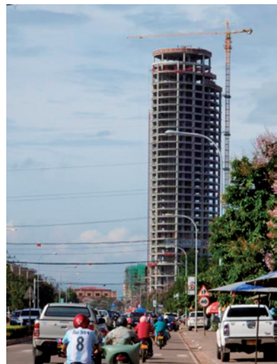
写真4 ラオスで初の超高層建築物(33階建のホテル:建設中) - 2015年8月撮影 -
