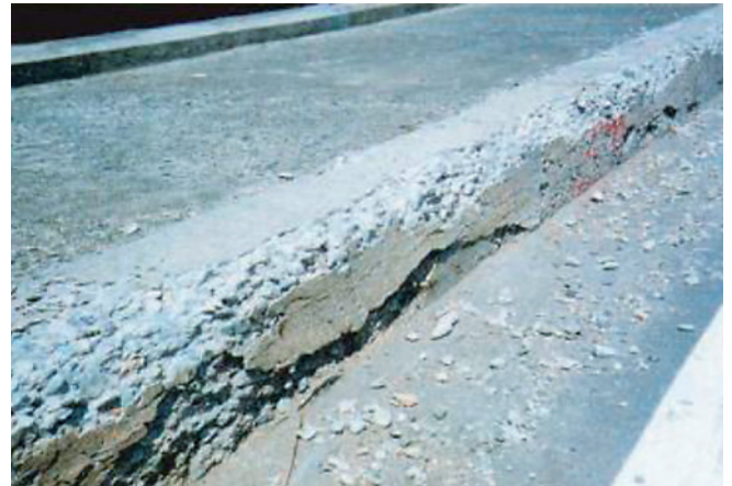
写真1 凍結融解作用による劣化の一例 (スケーリング)
