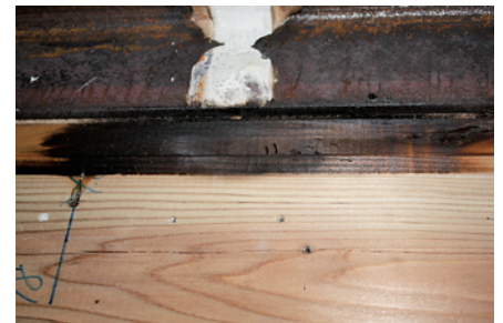
写真6 試験後の梁と床の接合箇所状況
